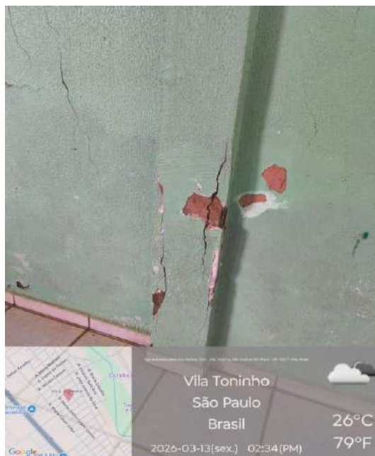
Imagem 6.3.2: O registro fotográfico apresenta uma manifestação patológica de caráter estrutural, configurada por uma trinca escalonada que se desenvolve no pilar, acompanhando as juntas de assentamento horizontais e verticais da alvenaria. A orientação e a geometria da descontinuidade sugerem a atuação de tensões de cisalhamento e tração, comumente originadas por movimentações diferenciadas da estrutura ou processos de recalque de fundação, resultando na perda da integridade física e funcional do plano de vedação. Sob a ótica da engenharia diagnóstica, a magnitude e o padrão da abertura indicam que as solicitações mecânicas excederam a capacidade de deformação, sendo necessário a execução de reforço estrutural para restabelecer a estabilidade.
